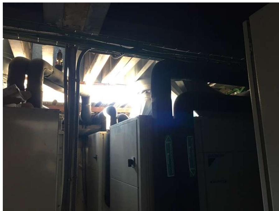
Silenciadores Bombas de calor Universidad Popular
