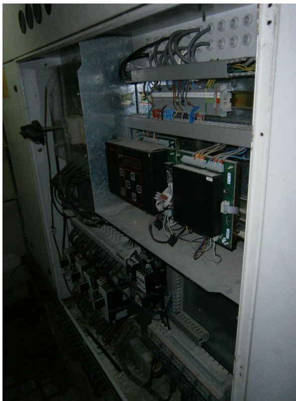
Cuadro control enfriadora antigua
