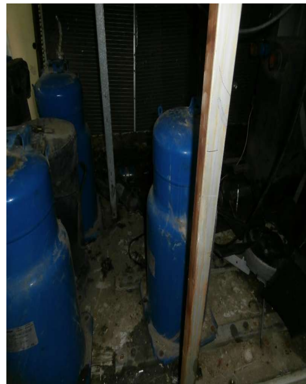
Circuito frigorífico enfriadora antigua
