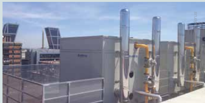
Calderas de condensación instaladas en la terraza del hotel.
